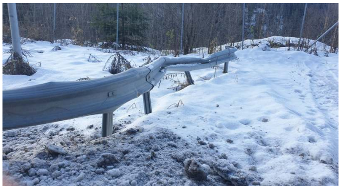
Autofendere ned mot E16 bærer tydelig spor av problematiske forhold med tunge biler på svært bratte veier. Foto Johannes Mylius
