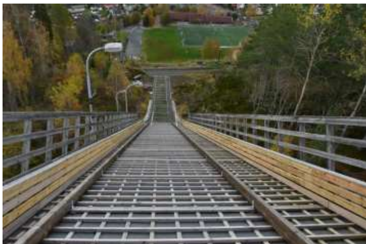
Sikkerhetsvant er skiftet ut. Det gamle var sprukket, oppflist og fylte ikke lenger sin funksjon.
