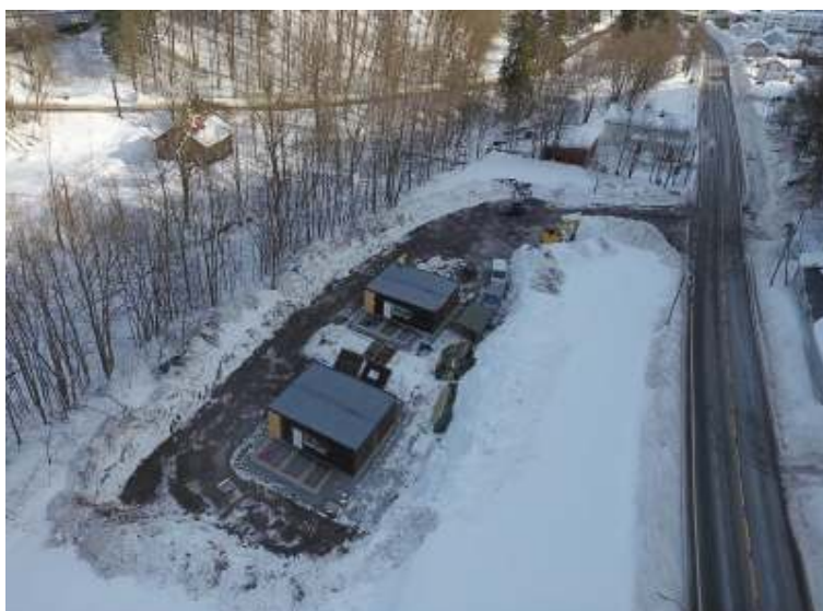
Bærum kommune Eiendom bygger hybelbygg i Isielvens avsatte grøntbelte og innenfor byggeforbudsgrense mot Isielven. Arbeidene er startet uten godkjenning fra Fylkesmannen Foto Bærum kommune.
