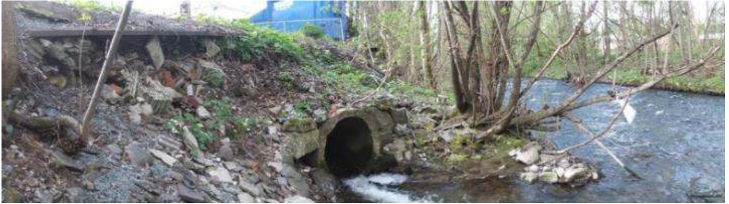
Ståvibekken er lagt i rør over elvesletten til Isielven. Bekken er prioritert åpnet og det er under utredning for å gjenåpnes i et nytt løp før Ståviveien og legges så videre i eiendomsgrensene.
